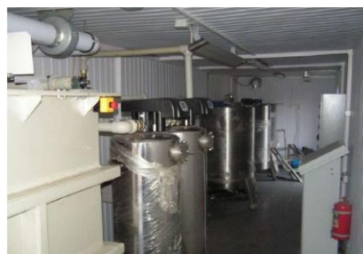
Foto 4.5. Tecnológica línea, sintonizada en el contenedor.
